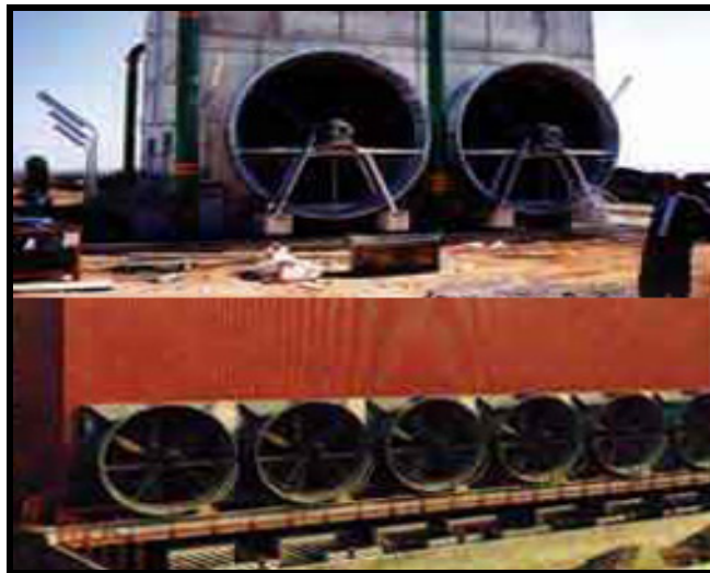
Fig. N° 6.9 Torre de tiro Forzado en operación
