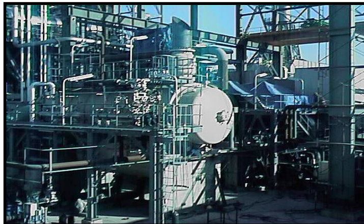
Fig. N° 5.5 Turbogenerador y Condensador.
