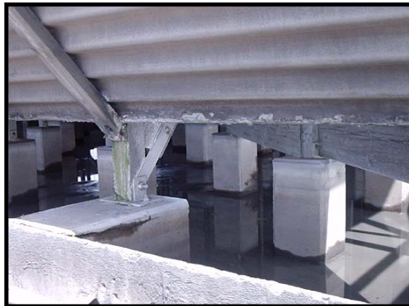
Fig. N° 7.8 Estanque de Almacenamiento del Agua.
