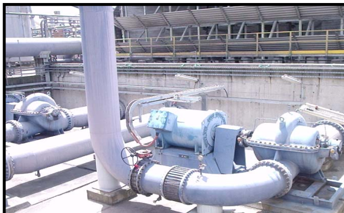
Fig. N° 7.9 Bombas de Agua de Enfriamiento.
