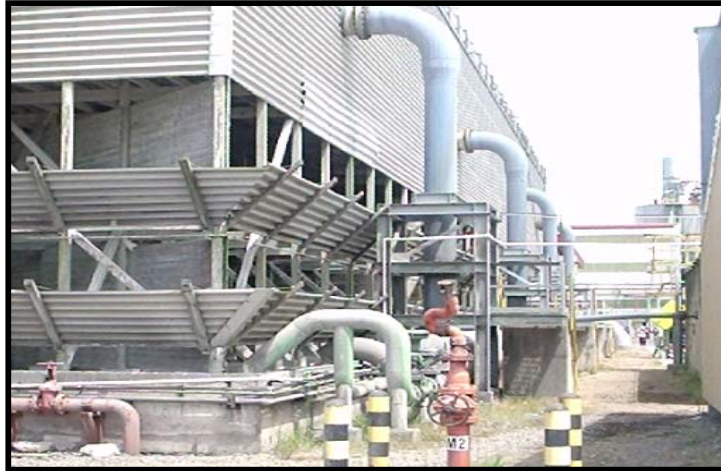
Fig. N° 7.2 Tuberías de distribución de la Torre de Enfriamiento.
