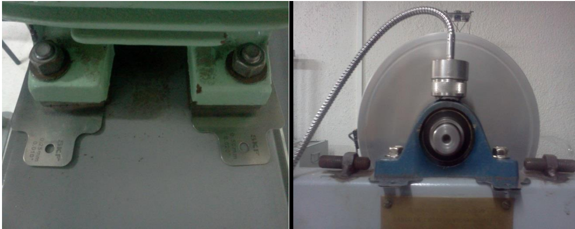
Figura 6.24. Corrección de “pie flojo” en apoyos de motor y rodamientos; vista de pernos para control de alineamiento en rodamientos del rotor.
