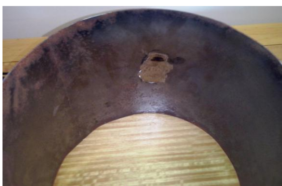
Fig. 4.2. Pérdida local de material a inspeccionar.
