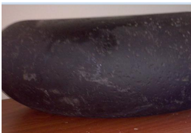
Fig.4.10. Codo con pitting exterior.
