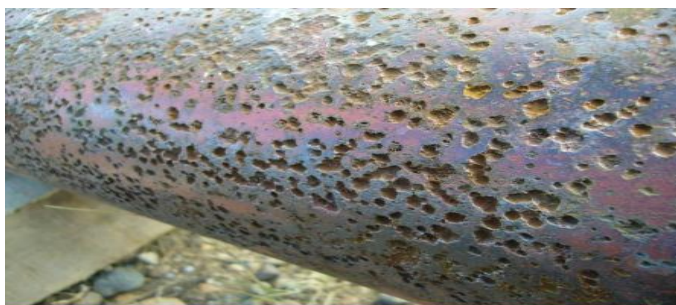
Fig. 4.8. Ejemplo de una tubería con pitting
