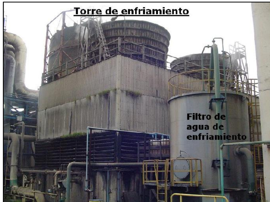
Figura 3.4 Torre y filtro del agua de enfriamiento.
