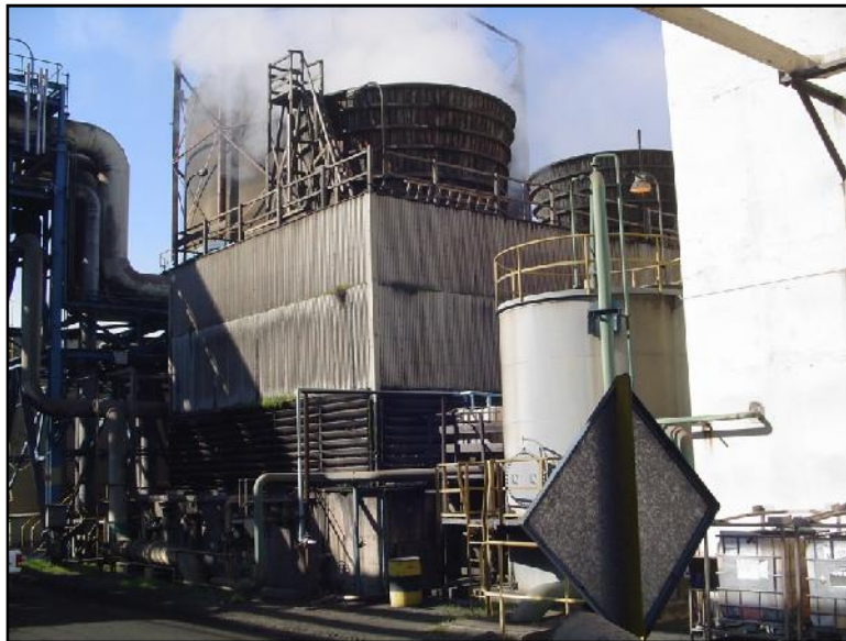
Figura 2.8 Torres de enfriamiento.
