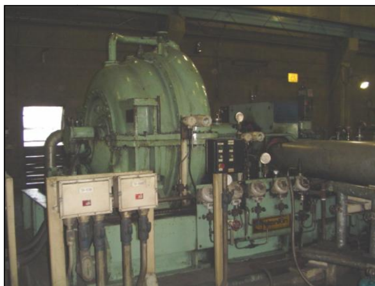
Figura 2.10 Aspiradora del gas coque.
