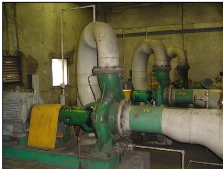
Figura 3.3 Sala de bomba de circulación de agua de enfriamiento.
