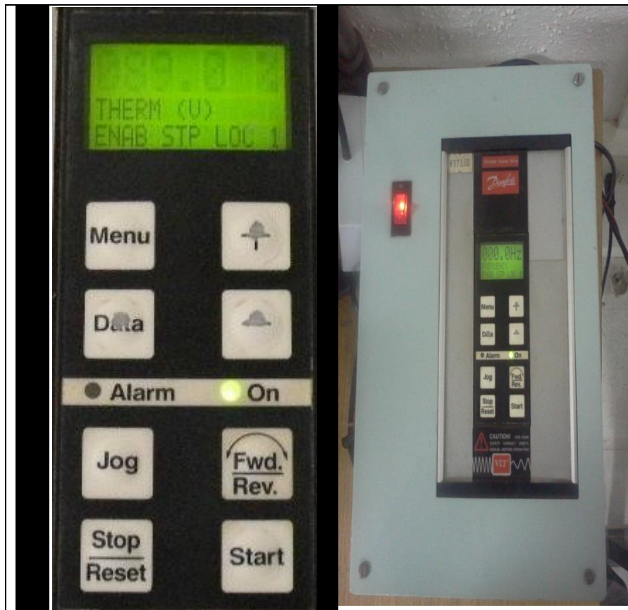
Fig. N° 5 Variador de frecuencia Danfoss
