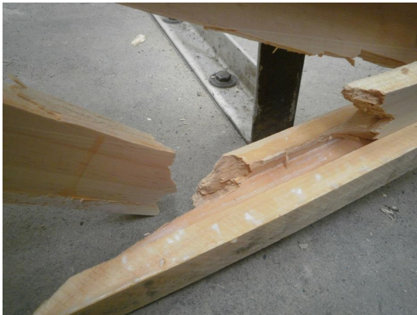
Figura L22: Falla por desprendimiento del alma (falla secundaria).
