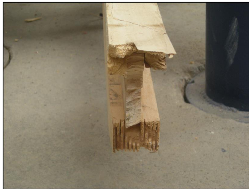
Figura L16: Falla de la unión finger-joint ala inferior (falla primaria).
