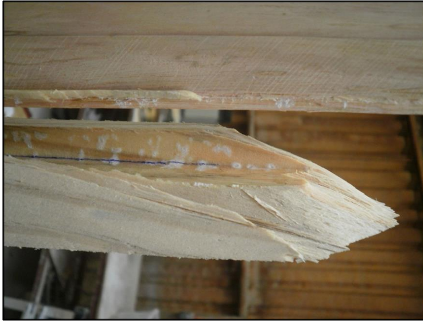
Figura L39: Falla por desprendimiento del alma (falla primaria).
