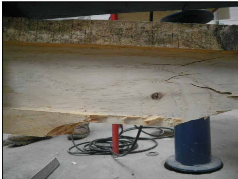
Figura L28: Falla por nudo en el ala inferior (falla primaria).
