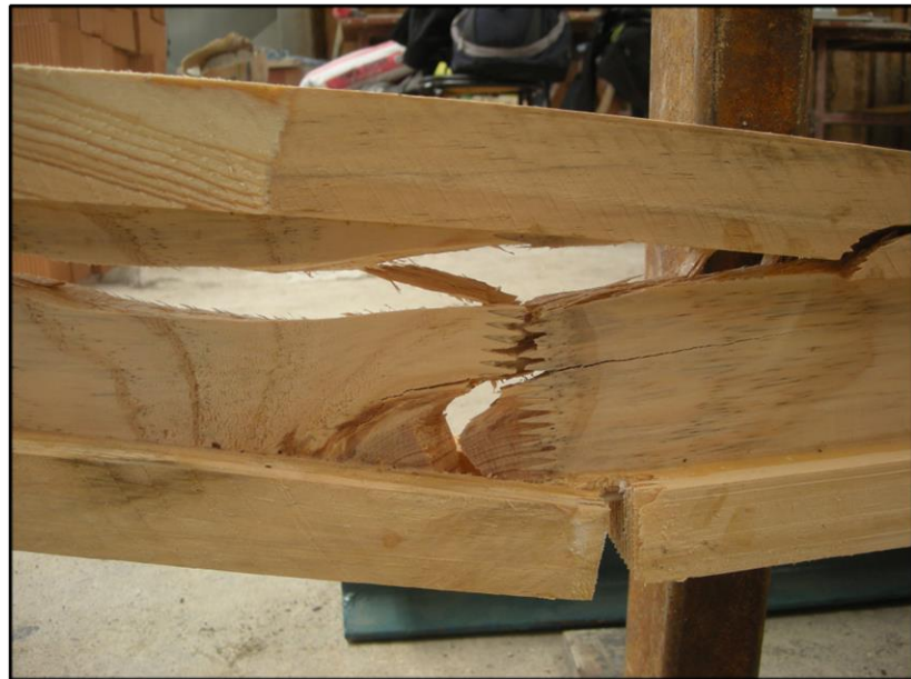
Figura L20: Falla de la unión finger-joint ala inferior (falla secundaria).
