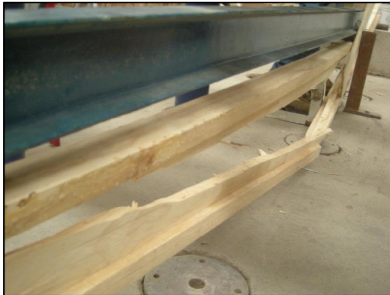
Figura L8: Falla por fractura total (falla primaria).
