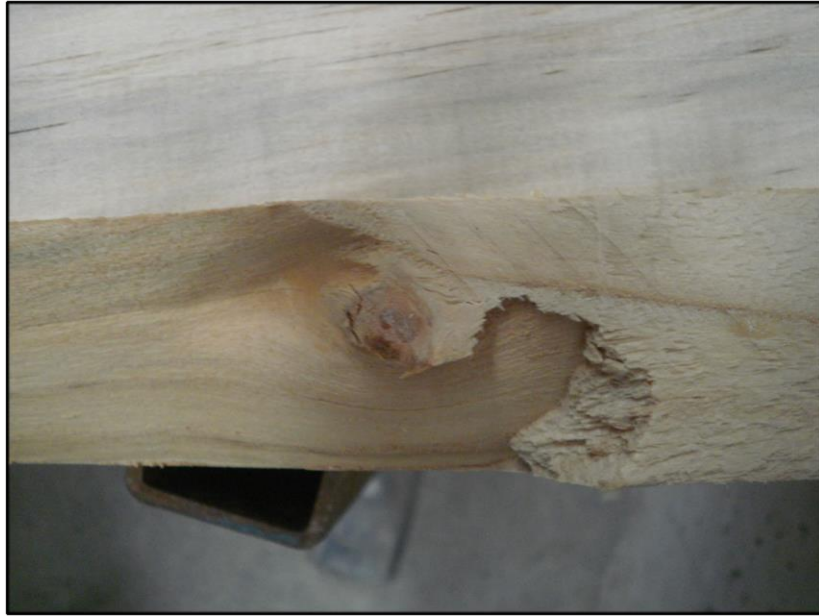
Figura L23: Falla por nudo en el ala inferior (falla primaria).
