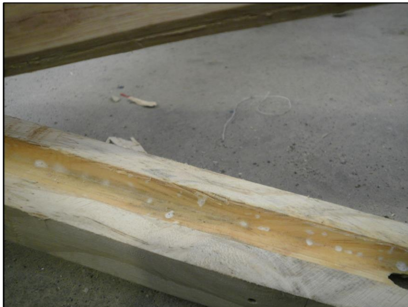
Figura L40: Falla por desprendimiento del alma (falla primaria).
