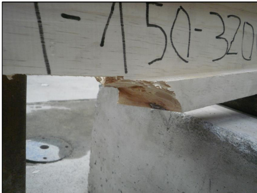
Figura L30: Falla por nudo en el ala inferior (falla primaria).
