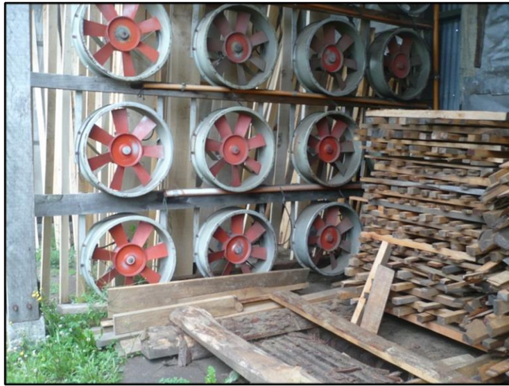
Figura B3: Cámara de pre-secado.
