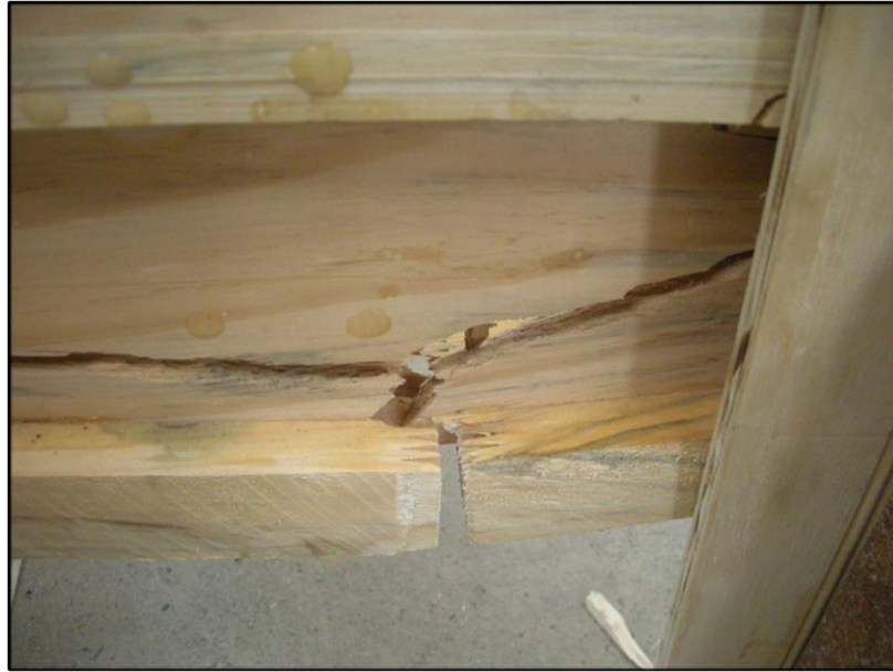
Figura L5: Falla de la unión finger-joint ala inferior (falla primaria).
