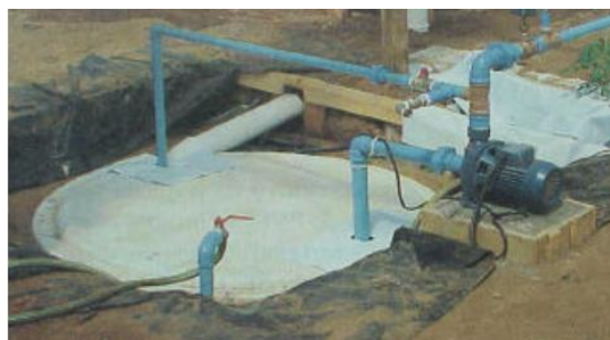
Figura N°6.6 Instalación de Bombeo
