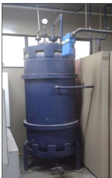
FIGURA N° 2.4 Estanque almacenador de aire.
