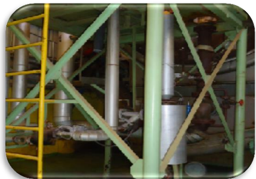
Figura 9.3 Alimentación de vapor
