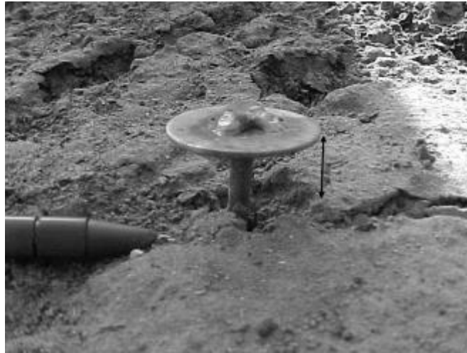
Figura 9: Clavo de erosión en areniscas de Arizona, después del incendio forestal Rodeo-Chediski (Fuente: García-Chevesich, 2005)
