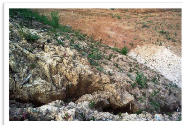
Figura 4: Talud Erosionado Penco (Fuente: Elaboración propia)
