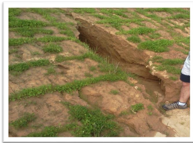
Figura 1: Talud erodado, Obra en rivera de río Andalién (Fuente: Elaboración propia)
