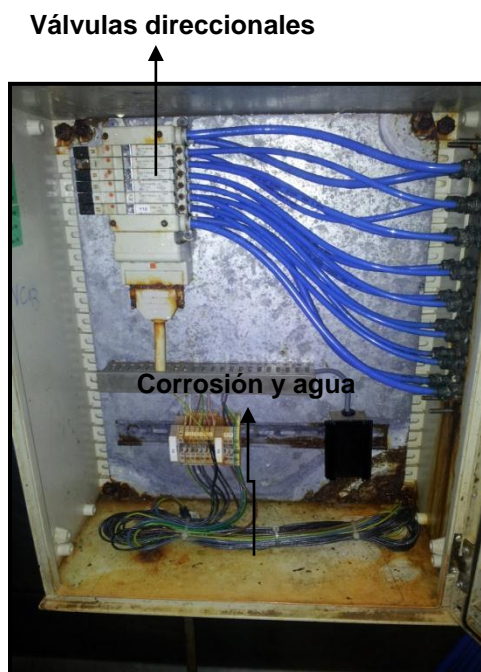
Figura 3.5. Deterioro de los componentes.
