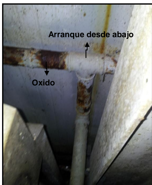
Figura 3.4. Estado actual de cañerías.
