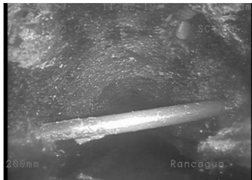
Figura 7: Tubería con incrustación en escala de grises. Fuente: (Elaboración propia)
