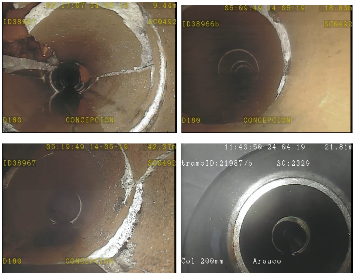
Figura 50: Imágenes con roturas, fisuras y desacople Fuente: (Inggepro Ltda.,2019)
