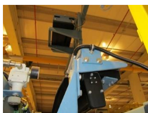
Imagen 2.4: Cámara de defectos
