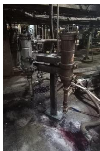
Imagen 4.19: Filtro de baja en nivel de subsuelo
