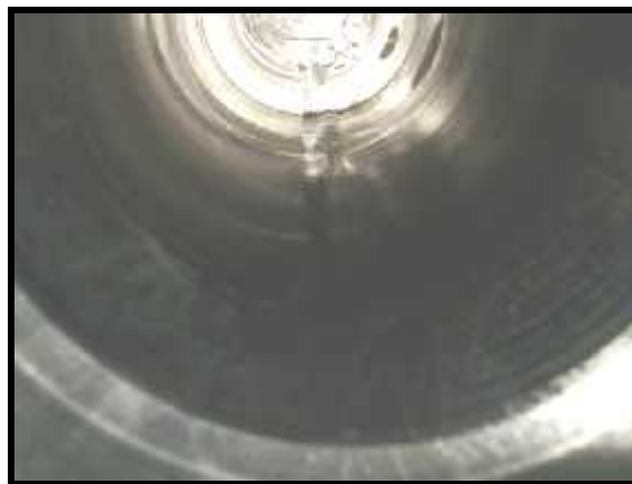
Figura 3.9: Estado Interno Cilindro.
