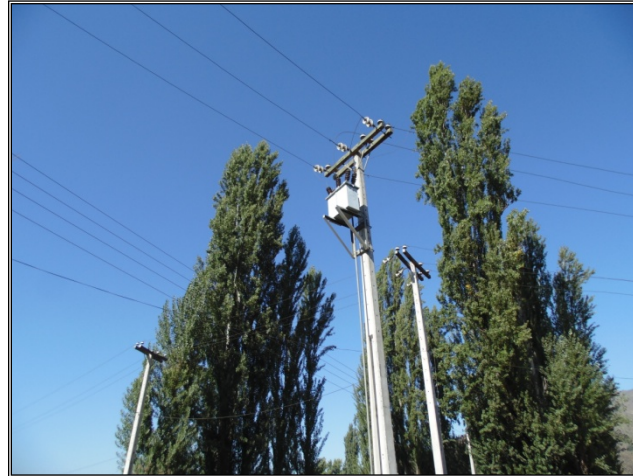
Fig 3.1 Transformador de media tensión.
