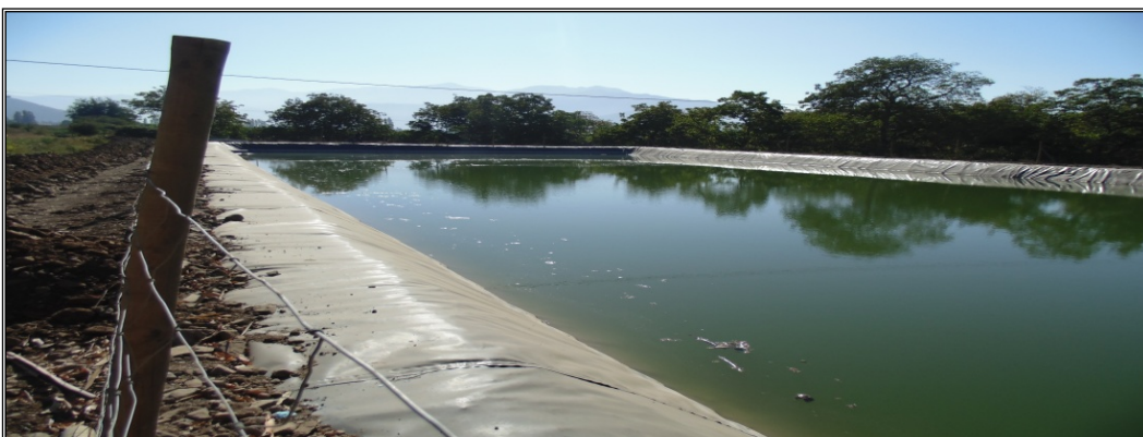
Fig. 1.6 Tranque plastificado con [1] Geomembrana para evitar filtraciones.
