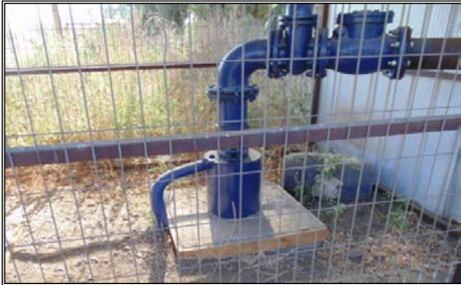
Fig. 1.3 Bomba de pozo a 35m de Profundidad.
