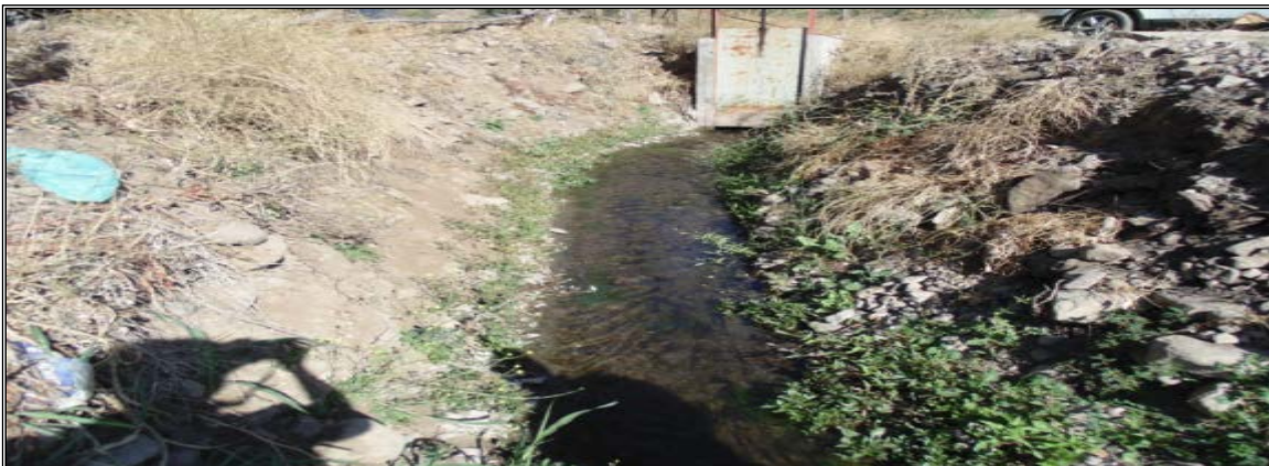
Fig. 1.2 Canal de captación de agua.
