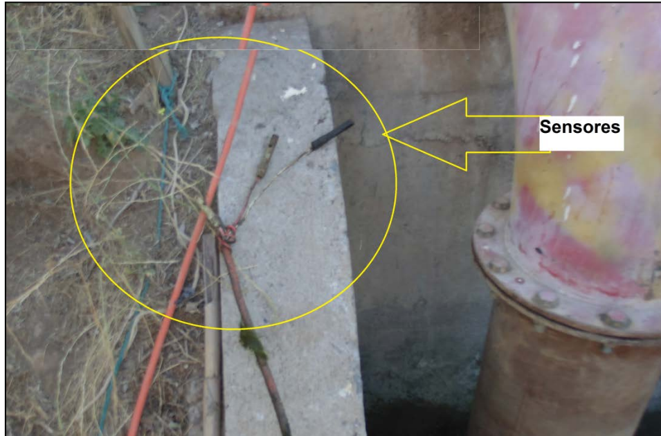
Fig 4.3 Sensores de nivel
