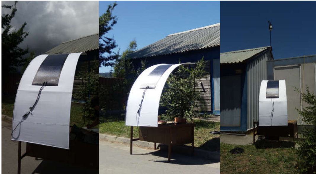
Figura 54: Fotografías de la instalación para los tres casos estudiados.
