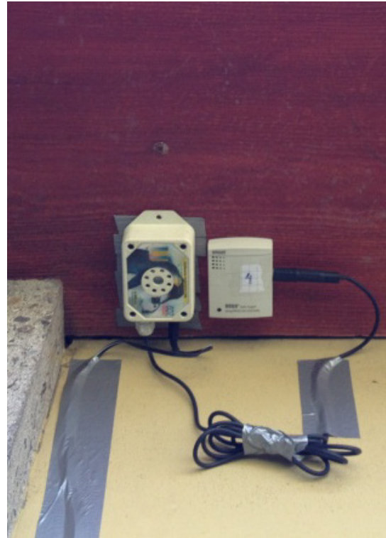
Figura 4.8: Sensores ubicados en el exterior del aula Caso A.
