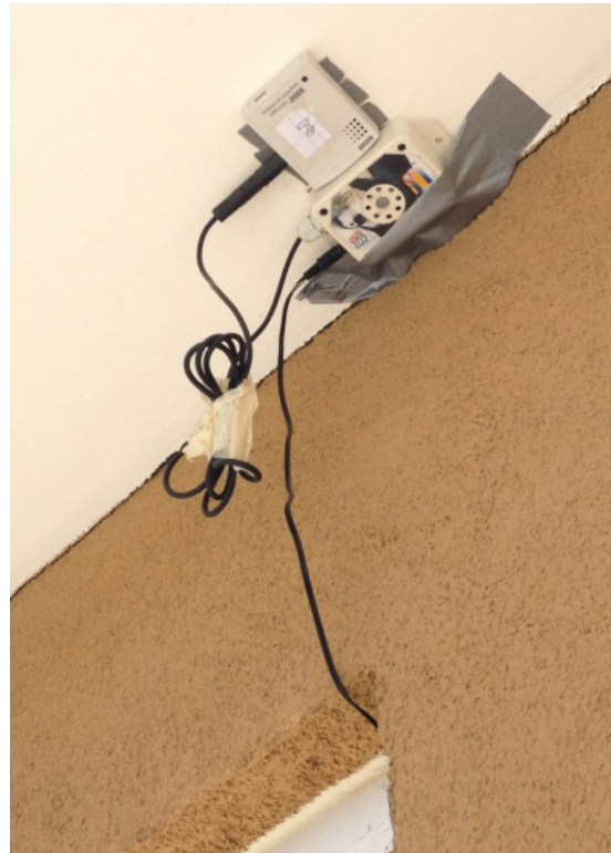
Figura 4.11: Sensores ubicados en el exterior del aula Caso B.
