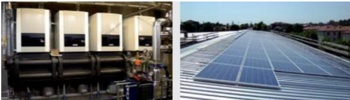
FIGURA 22: CALDERAS CONDENSACIÓN (IZQ.) Y PANELES FOTOVOLTAICOS (DER.)
