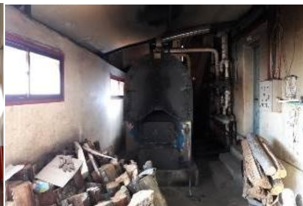
FIGURA 30 SALA DE CALDERA
