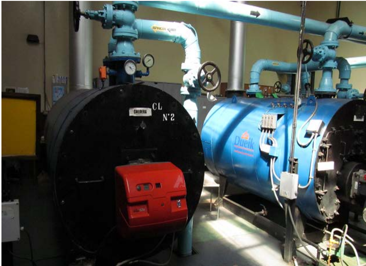
Figura 2.5. Sala de calderas.
