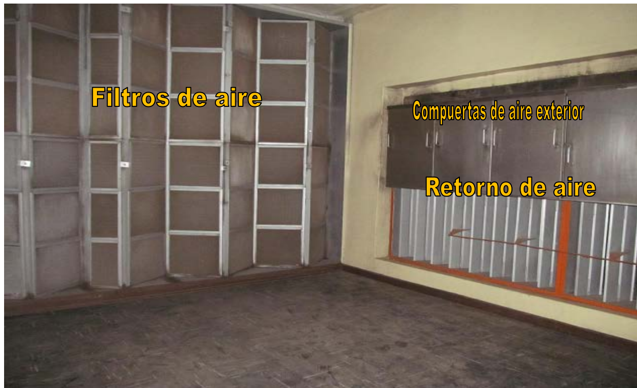
Figura 2.7. Climatizador, retorno del aire y filtros.
