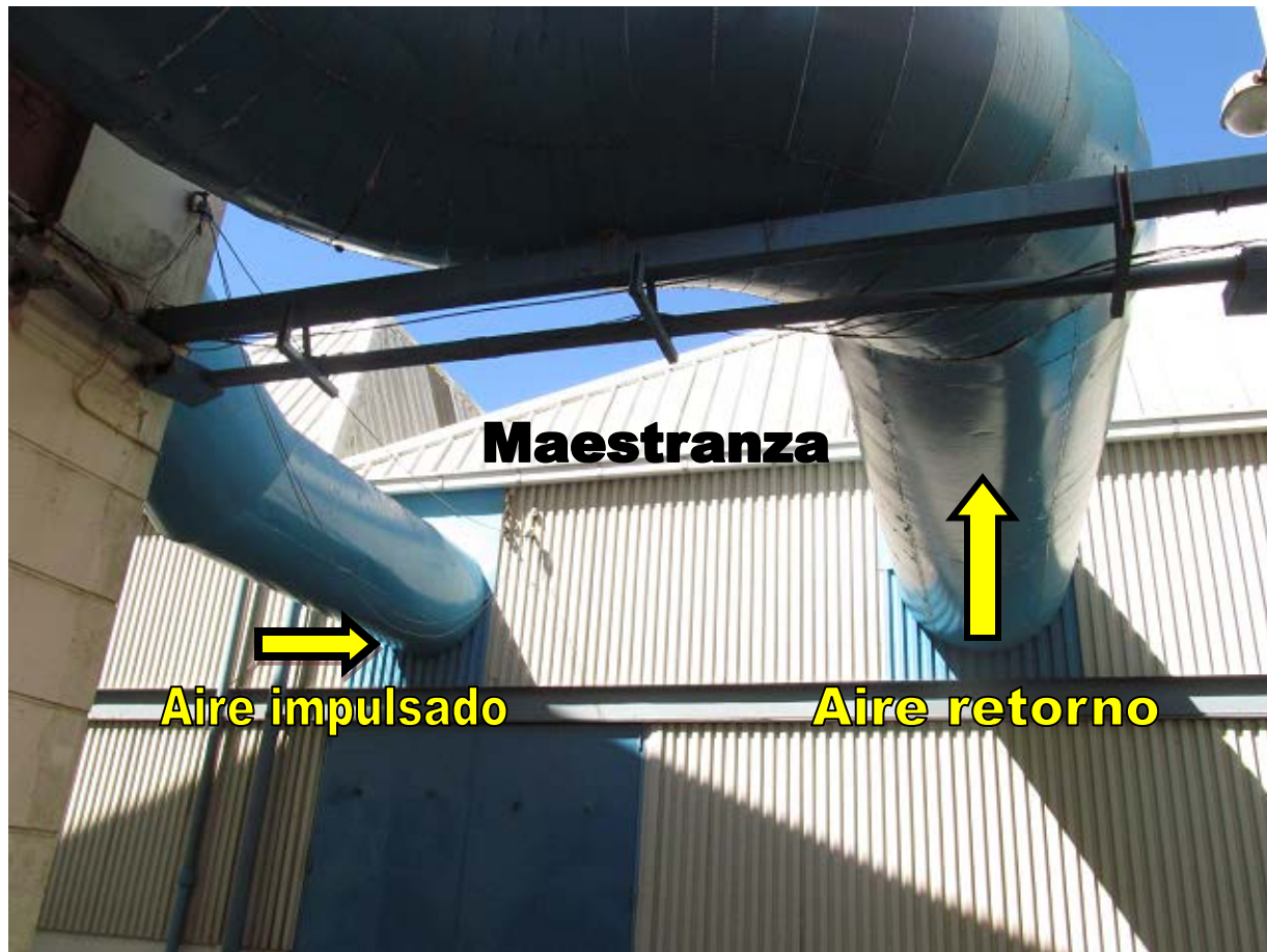
Figura 2.9. Ductos exteriores de aire al recinto.
