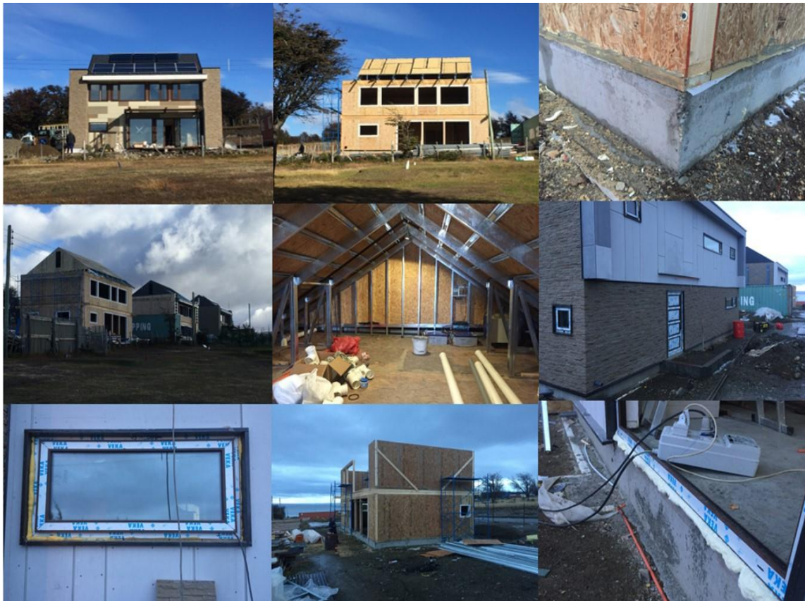
Figuras 40: Set de fotografías proceso constructivo de vivienda IMPASIVHAUS, usada de base para la proposición de estándares mínimos óptimos (Inmobiliaria Los Albatros)
