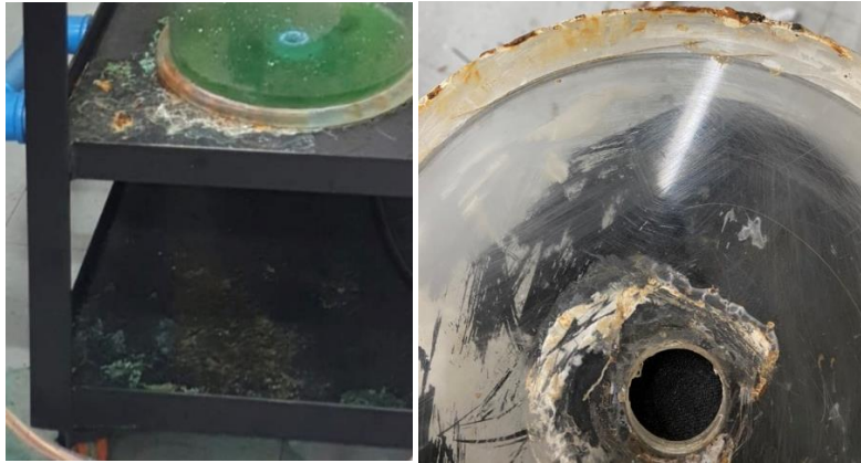
Fig. 9 "Estanque en mal estado"
