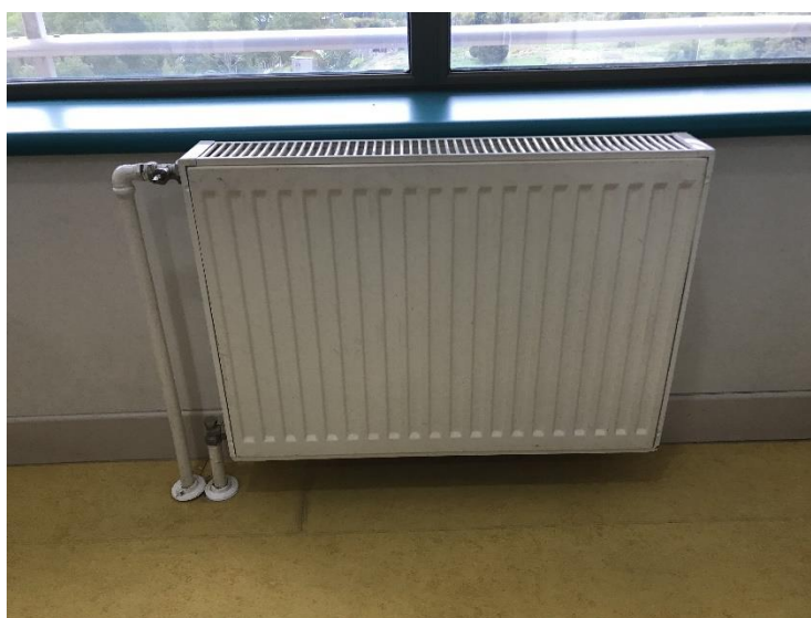
Figura 4.14. Sistema de calefacción de las SCHB, a través de radiadores de agua caliente
