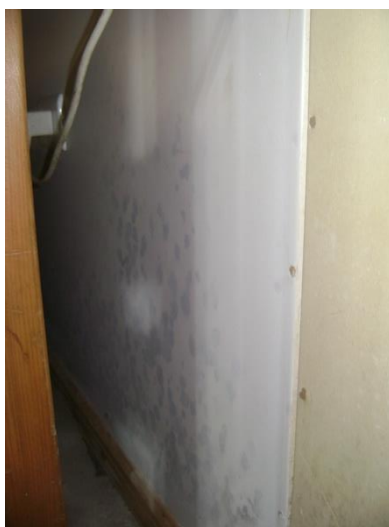
Figura 1.3: Vivienda social afectada por humedad por ocupación. (Fuente: SERVIU Los Ríos, 2010)
