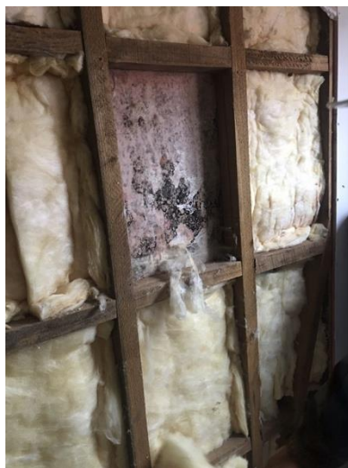
Figura 1.2: Vivienda social en proceso de construcción afectado por humedad producto de la lluvia. (Fuente: SERVIU Los Ríos, 2013)
