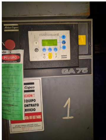
Figura 14. Compresor Atlas Copco GA75
