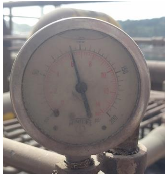
Figura 9. Manómetro entrada a acería (6.3 bar)
