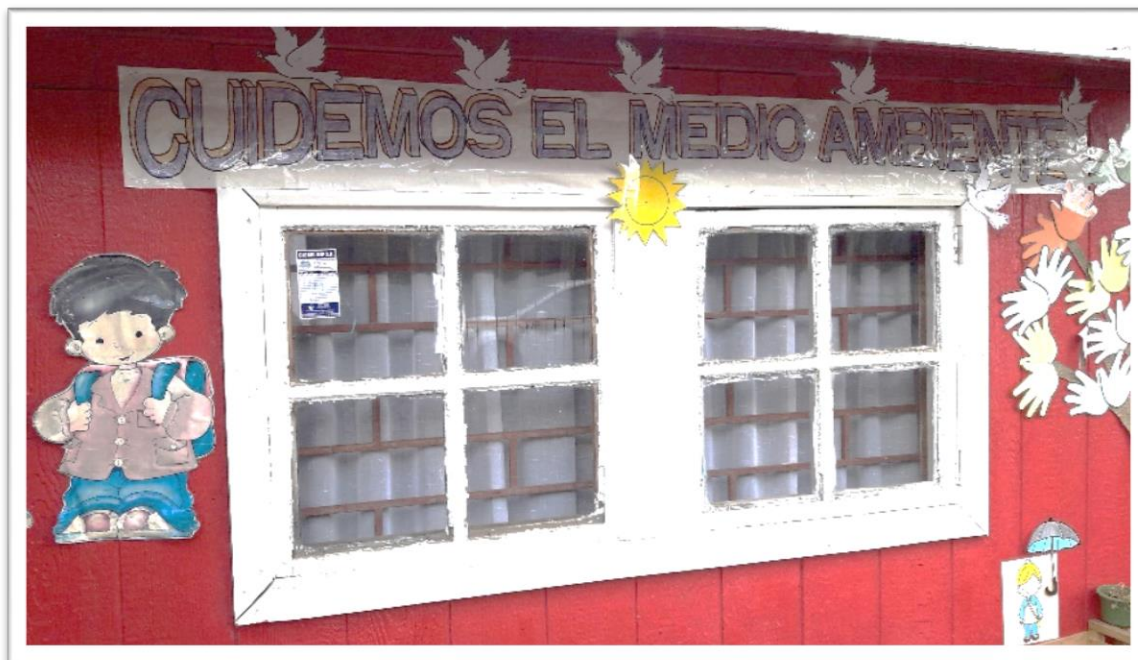
Fotografía 2: Se presenta el estado en el que se encuentra el invernadero escolar. El cual según consta por el trabajo de campo, no es utilizado hace dos años (Escuela C).
