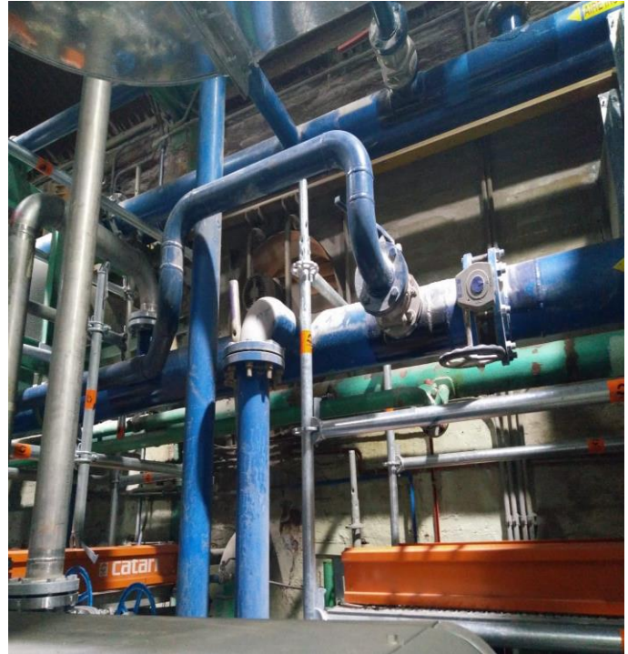
Figura 26. Cuello de ganso en sala de compresores
