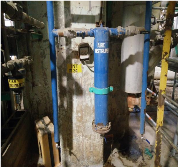
Figura 16. Sistema de filtrado y purgadores
