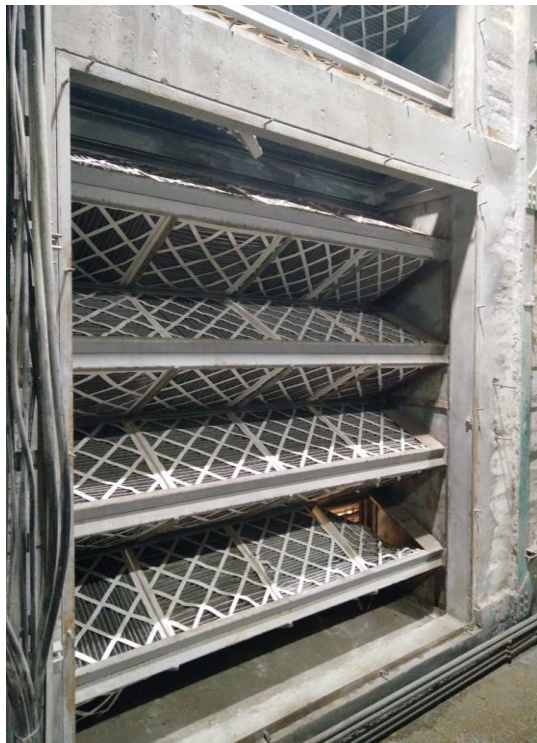
Figura 27. Filtros en sala de compresores
