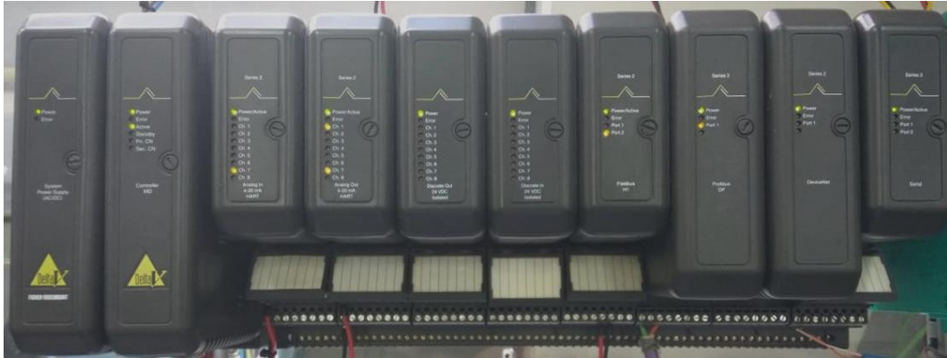
Figura N° 1: Controlador Delta V con sus módulos
