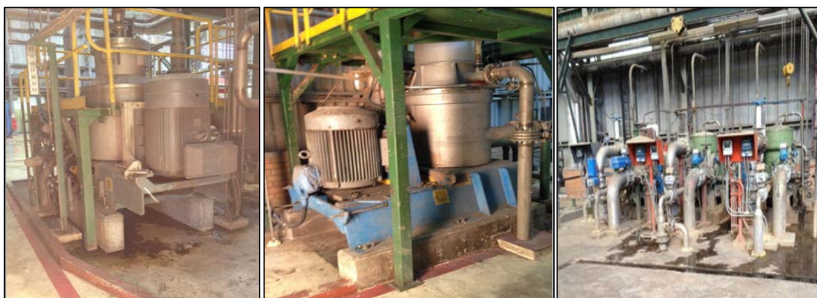
Figura 205. Depurador grueso primario (15E207), depurador grueso secundario (15E209) y depuradores finos (15E56, 15E57 y 15E73) FPC Papeles.
