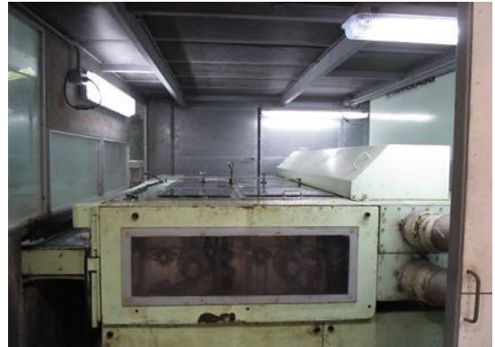
Figura 26. Zona de lavado
