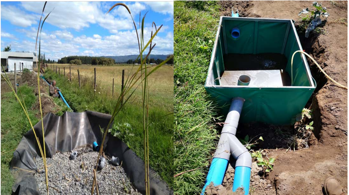
Figura 9: En la izquierda podemos apreciar la conexión entre el tratamiento primario (al fondo de la imagen) y el tratamiento secundario, en cambio a la derecha vemos la conexión desde donde se recopilan las aguas desembocando en el tanque séptico. (Fuente Propia).
