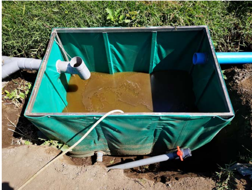
Figura 11: En la figura encontramos el sedimentador en fase de puesta en marcha, se puede apreciar la salida lateral, utilizada para la extracción de lodos. (Fuente propia).
