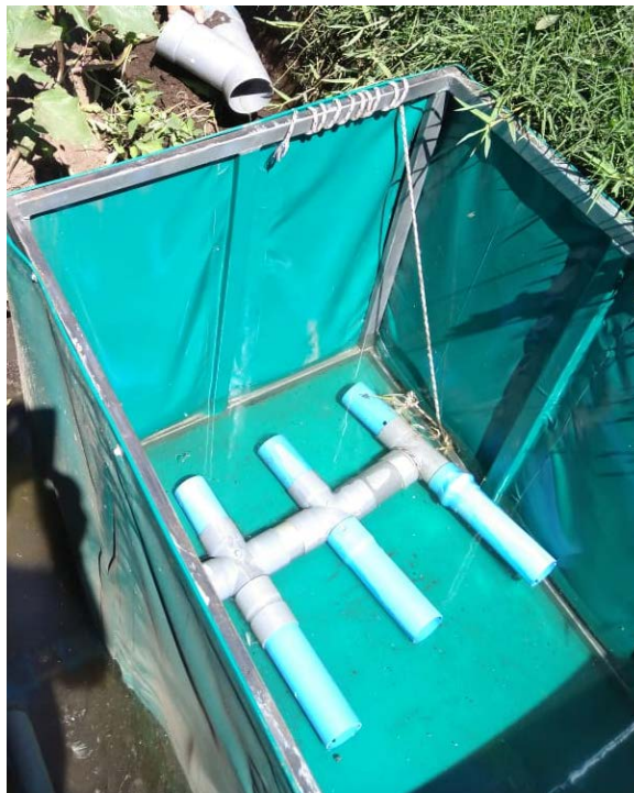
Figura 10: Sistema de drenes extractores de lodo, utilizados en el fondo del tanque sedimentador (Fuente Propia).
