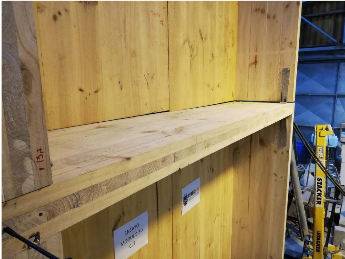
Figura C12: Estado Ultimo en Junta Vertical Ensayo N°2.
