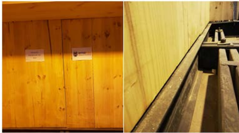
Figura 40: Estado Ultimo Junta Vertical Ensayo N°1 (Izquierda) y Ensayo N°2 (Derecha) (Elaboración Propia, 2019).
