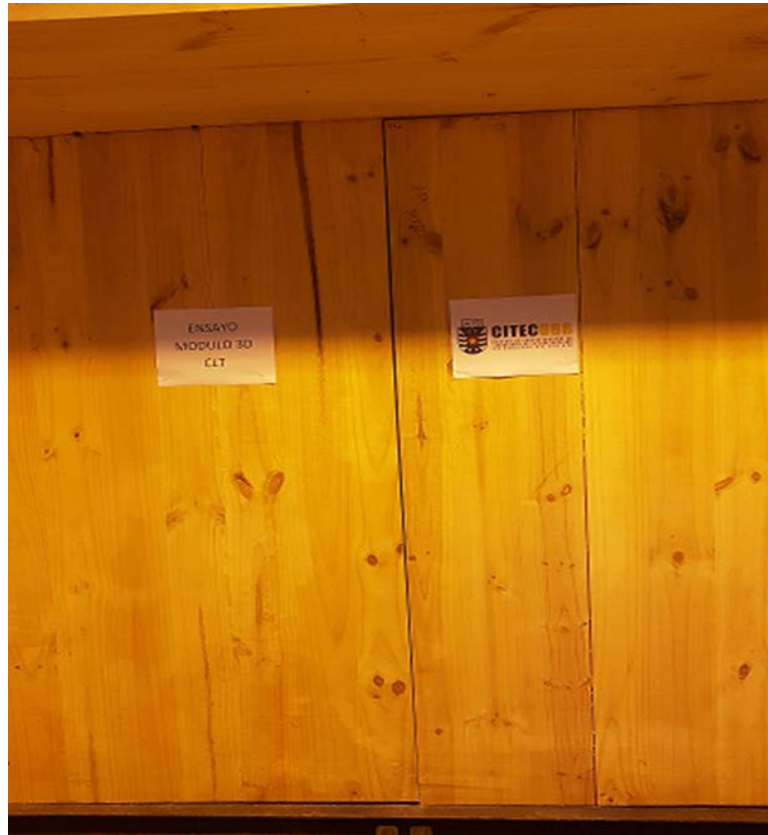
Figura C10: Estado Ultimo en Junta Vertical Ensayo N°1.
