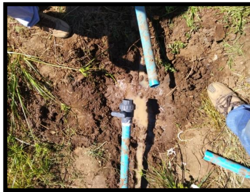
Figura A5: Válvula de control del afluente.
