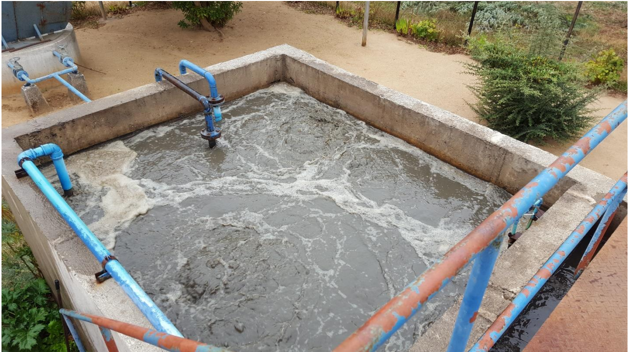
Figura 4: Tanque de aireación. Fuente: Elaboración propia.
