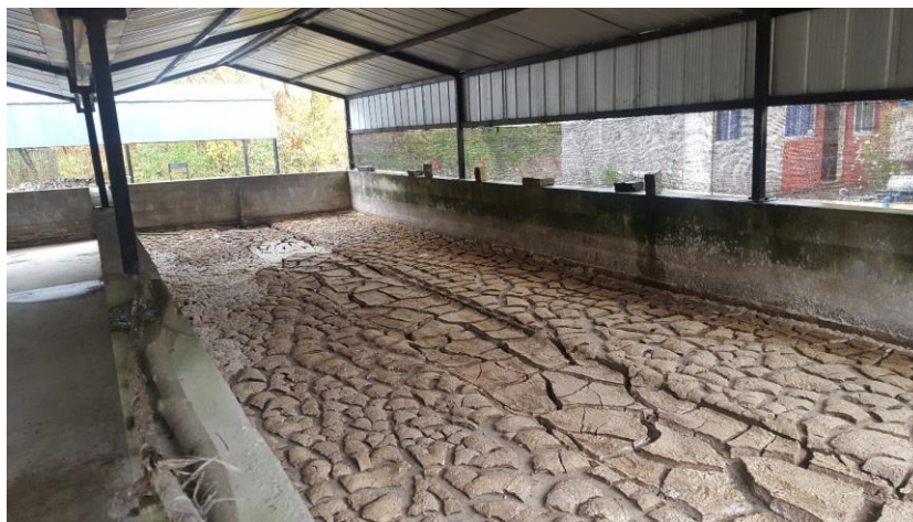
Figura 9: Lecho de secado de lodos.
