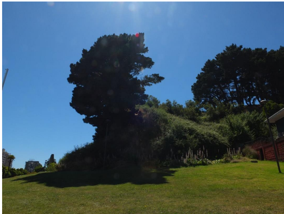
Figura 3. Cara lateral N°1 – Talud en estudio.
