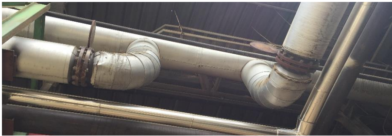
Figura 5.6: Extracciones de vapor deficientes (Fuente: Elaboración propia)
