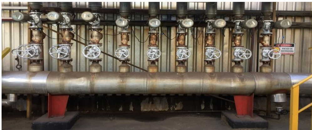
Figura 3.1: Manifold para cámaras 1,2 y 3 (Fuente: elaboración propia)
