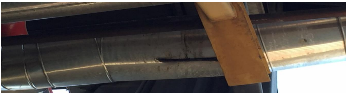
Figura 5.2: Daños protector de aislación debido a golpes de ariete (Fuente: Elaboración propia)
