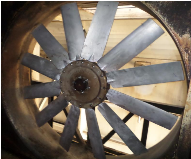
Figura 3.10: Ventilador cámaras de secado,(Fuente:[3])
