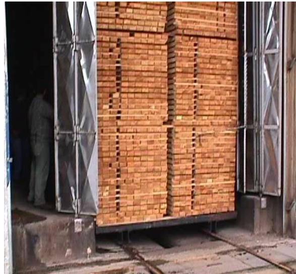
Figura 3.11:Deflectores cámaras de secado(Fuente:[3])
