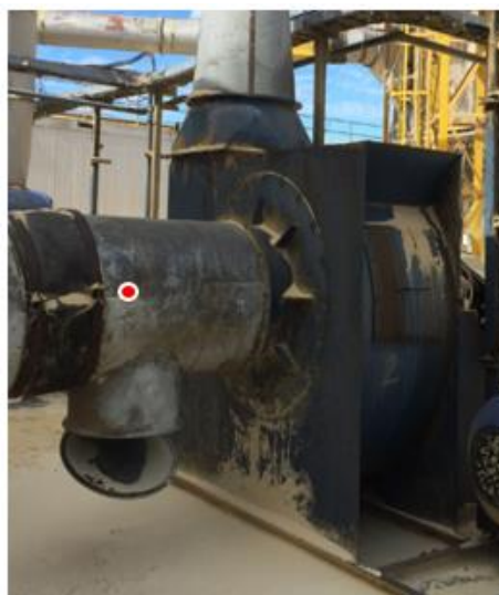
Figura 4.3 Perforación en rojo correspondiente al punto 7, entrada de ventilador
