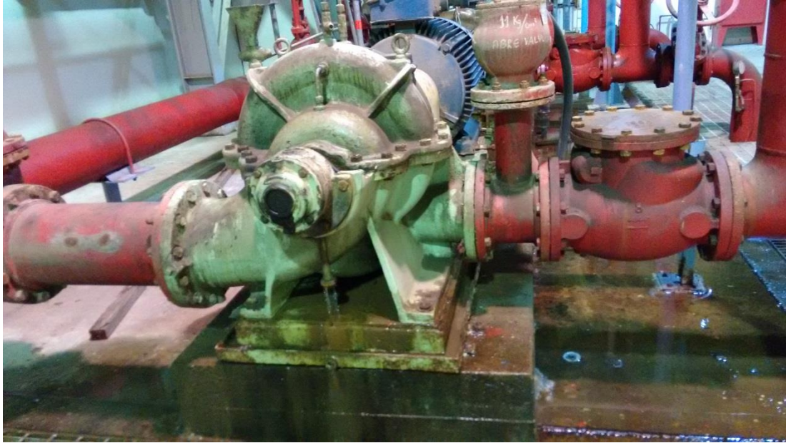
Figura 8 Bomba 223-21-003 y motor 223-31-003 instalado en Planta Arauco (la Bomba 223-21-002 y el motor 223-31-002 son homólogos a la Figura 8).
