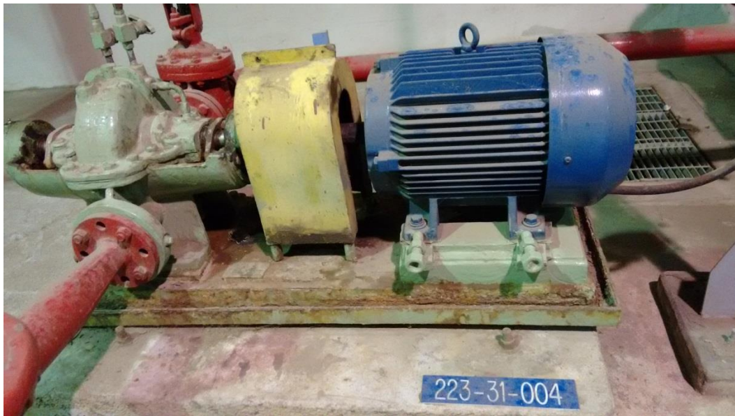
Figura 9 Bomba 223-21-004 y motor 223-31-004 instalado en Planta Arauco.
