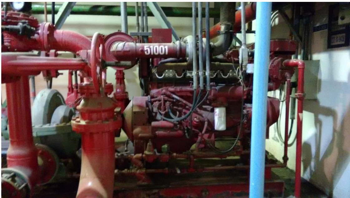
Figura 7 Bomba 223-21-001 y motor 223-51-001 instalado en Planta Arauco.
