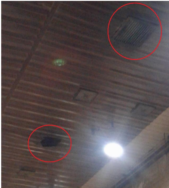
Figura 3.23 Ubicación de los extractores Fuente: Instalación de la planta
