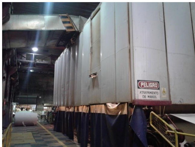
Figura 3.9 Zona de secado Fuente: Instalación de la planta
