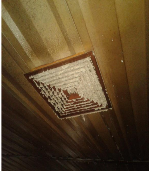
Figura 3.22 Rejillas de ventilación del recinto Fuente: Instalación de la planta
