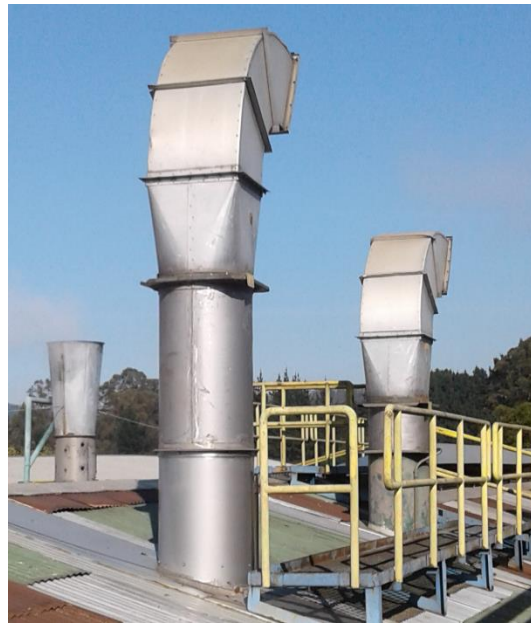
Figura 3.24 Salida al techo de los extractores Fuente: Instalación de la planta
