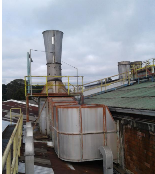
Figura 3.10 Extrator de la zona de secado Fuente: Instalación de la planta
