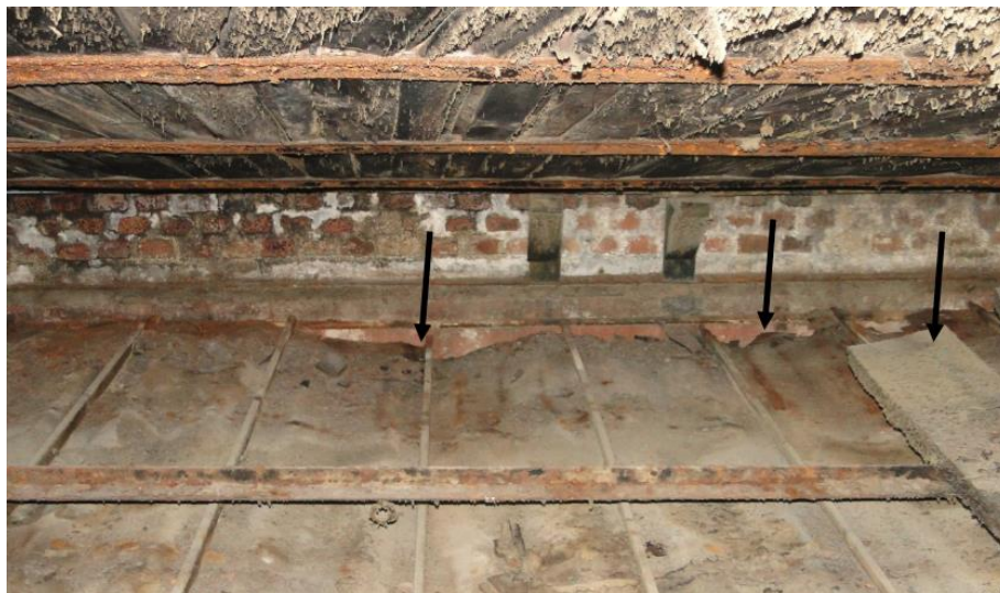
Figura 3.28 Daños en el cielo falso Fuente: Instalación de la planta
