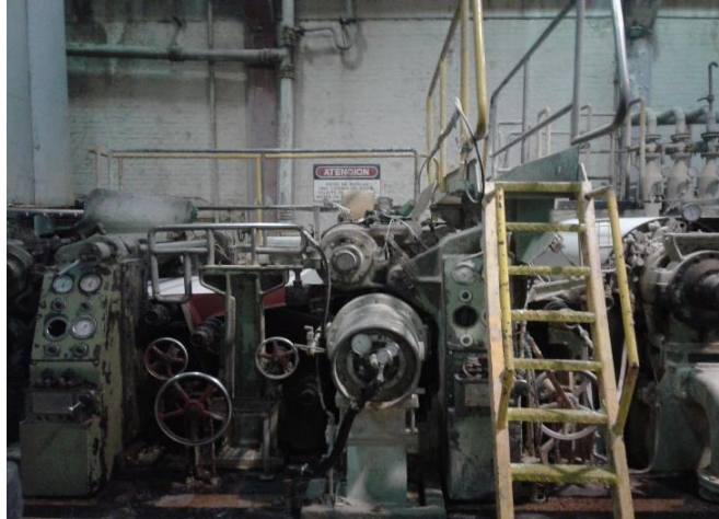
Figura 3.8 Zona de prensas Fuente: Instalación de la planta
