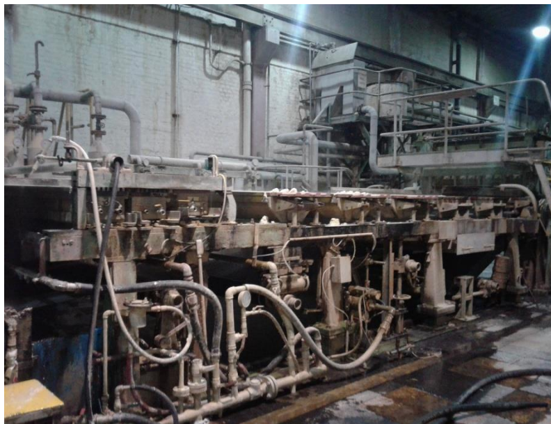
Figura 3.7 Zona de formación Fuente: Instalación de la planta
