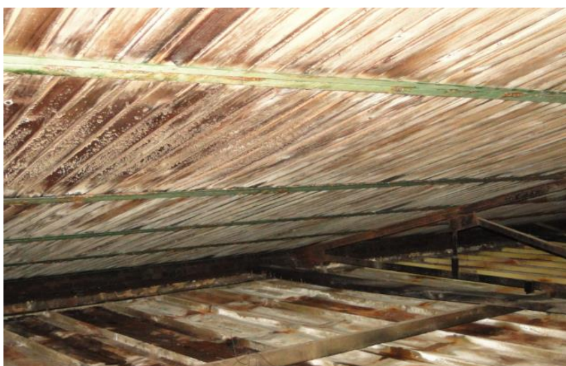
Figura 3.26 Zona de mejor estado Fuente: Instalación de la planta
