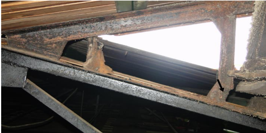
Figura 3.29 Corrosión en la campana del techo Fuente: Instalación de la planta
