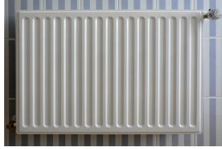
Figura 5.2: Equipo radiador instalado.
