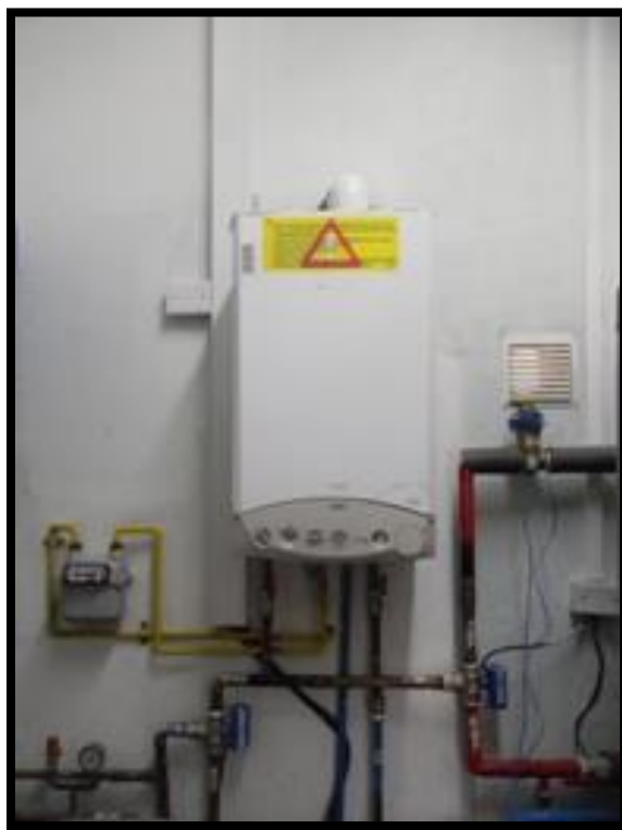
Figura 2.9: Caldera de condensación del edificio.
