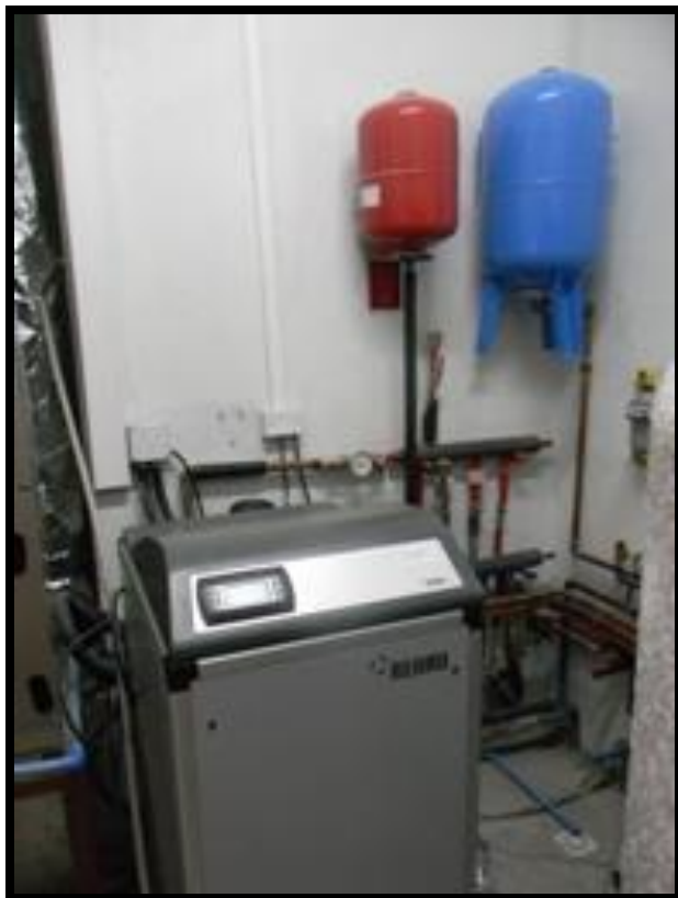
Figura 2.7: Bomba de calor geotérmica del edificio.
