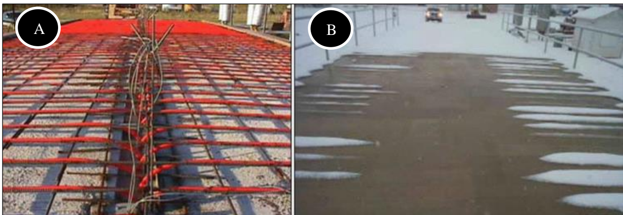
Fotografía 2.3 Sistema de deshielo de nieve para pavimentos. [9]
