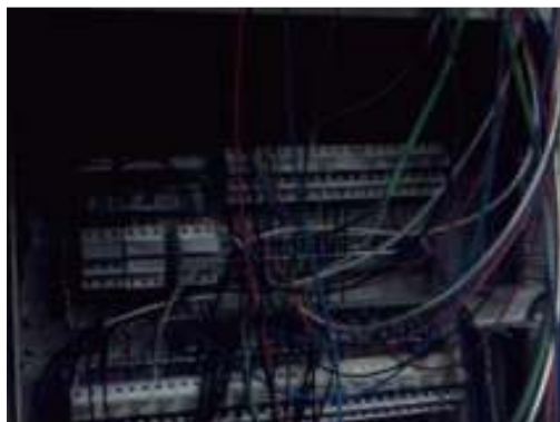
Fig 2.8: Imágenes del lugar (termográfica y normal)
