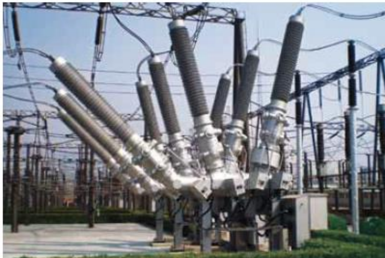
Figura 3.2: Vista de interruptor Siemens 3AP1
