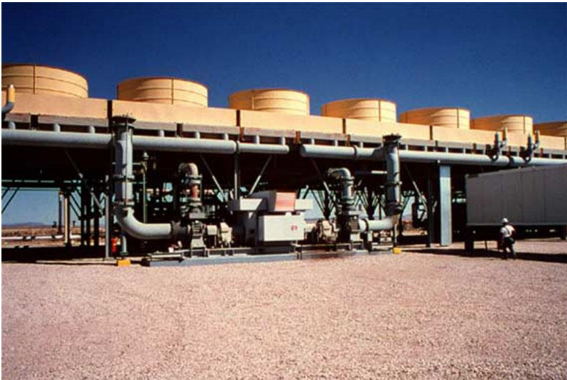
Figura 2.4: Sistema de torres de enfriamiento por aire en Soda Lake, Nevada.
