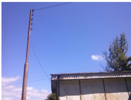
Figura N° 8.7: Acometida de la sala de control
