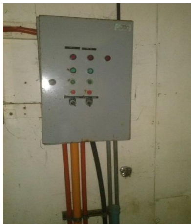
Figura N° 8.5: Tablero eléctrico antiguo y en desuso.
