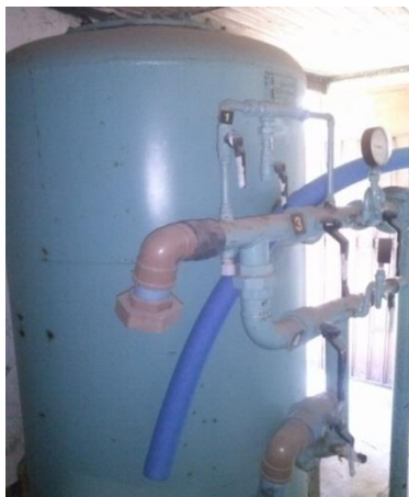
Figura N° 8.6: Estanque antiguo y en desuso.
