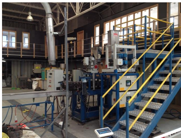
Figura 2. 3 Sala de procesos II
