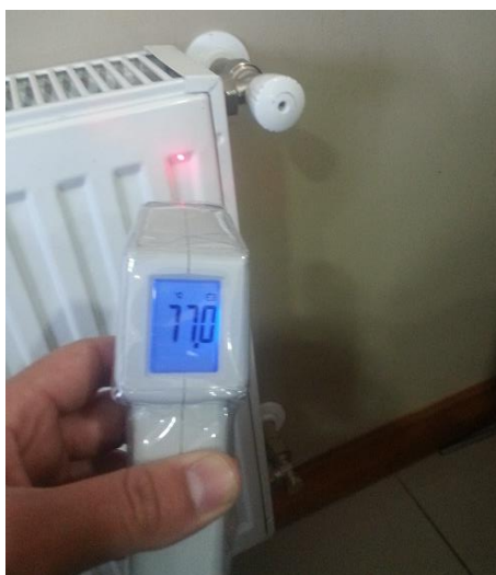
Figura 4. 22 Medición temperatura calefactores
