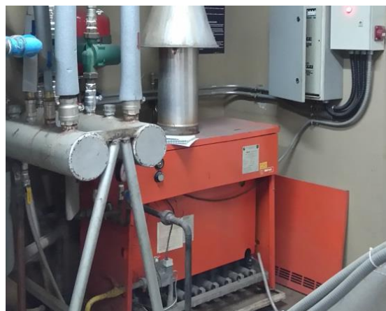
Figura 2. 12 Caldera de GLP
