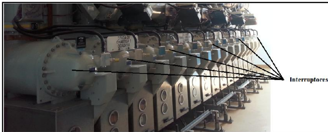
Figura 2.11: Vista de interruptores
