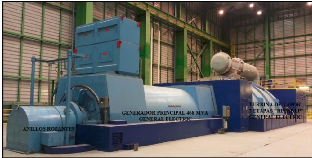
Figura 2.22: Vista del generador principal y turbina de vapor
