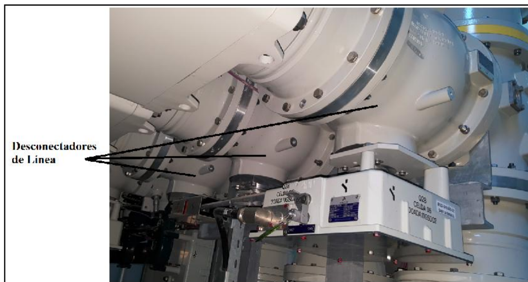
Figura 2.8: Vista del desconector de línea 89J1-1
