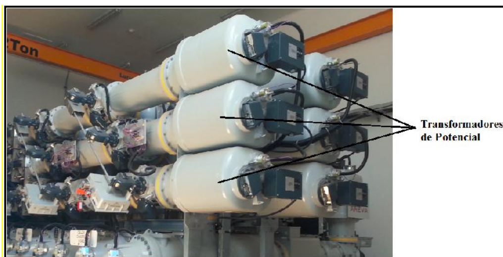
Figura 2.6: Vista de los transformadores de potencial ubicados en la subestación GIS
