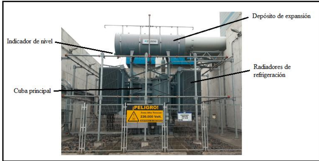
Figura 2.13: Vista transformador principal Step-Up
