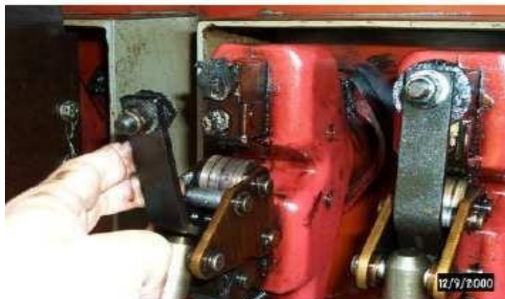
Fig. 23 Contactos colapsados debido al mal sincronismo
