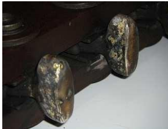
Fig. 25 Contactos del selector erosionados debido a la acción del arco eléctrico
