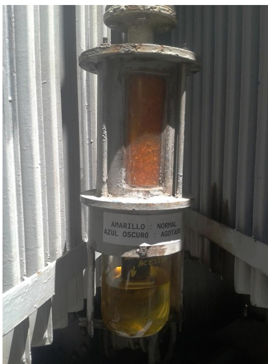
Fig. 29 Estado aceite cambiador de derivación
