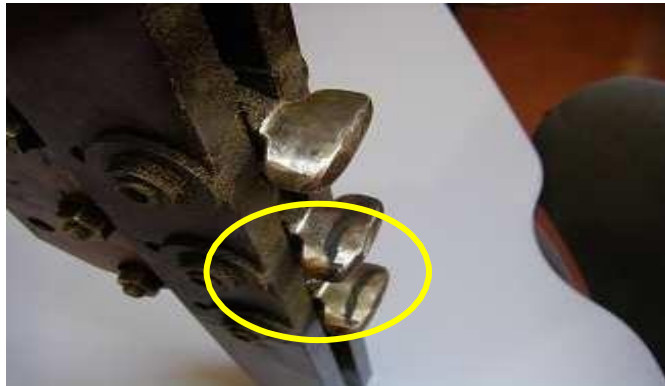
Fig. 24 Contactos fijos del selector desgastados
