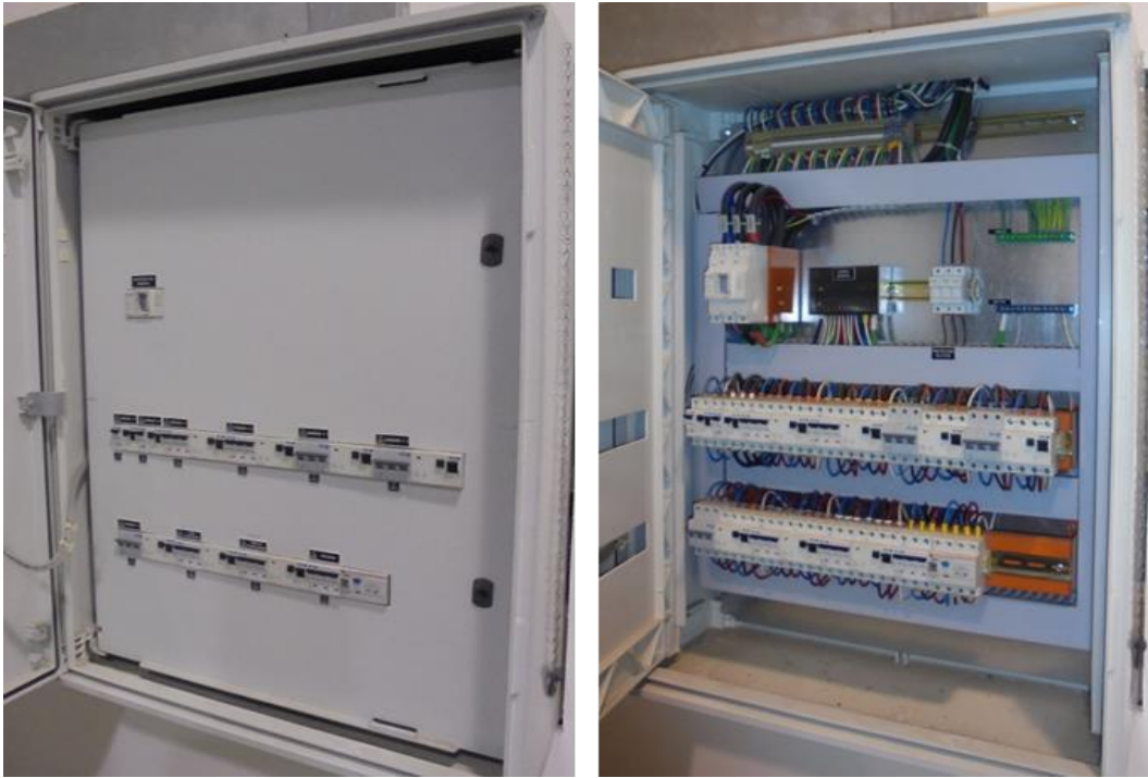
Fotografía 1 Tablero perteneciente al área de lavandería
