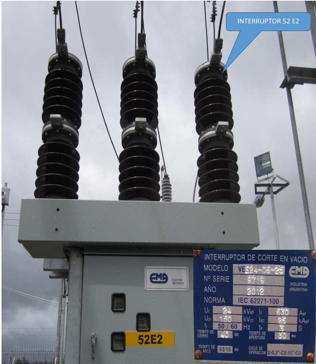
Figura 1.4: Vista del Interruptor de Cabecera Cabrero - Bulnes.
