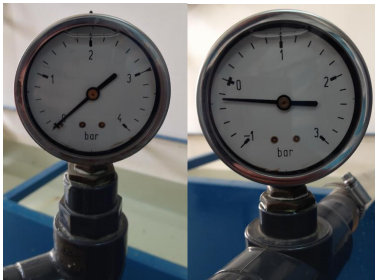
Figura N°9: Manómetros y vacuomanómetro. [3]
